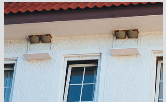
Kotbretter unter Mehlschwalbennisthilfen schützen die Fassade vor Verschmutzung
