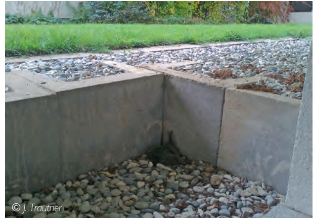
Verendeter Igel im Lichtschacht eines Untergeschossfensters, den er nicht mehr verlassen konnte.
